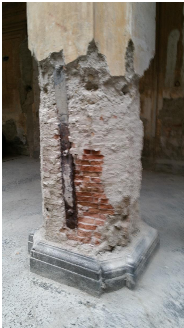
Ulteriore riparazione eseguita anni orsono su un altro pilastro simile a quello precedente – A. Spizuoco 2017
