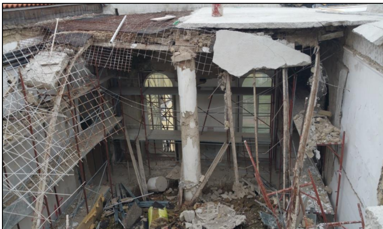
Residuo della zona crollata ove si nota lo schiacciamento localizzato in testa al pilastro “superstite” e la deformazione delle travi IPE sovrastanti – A. Spizuoco 2015
