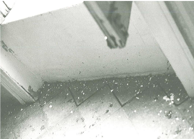
Dissesto estradosso solaio per tentativo di sfilamento travi sottostanti in corrispondenza di una finestra.
