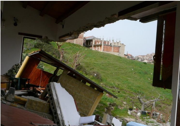
San Fratello (MA): All'interno di un fabbricato direttamente coinvolto nella frana – A. Spizuoco 2010
