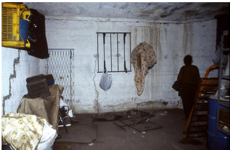
Lesioni su pareti perimetrali di un edificio - A. Spizuoco 2000
