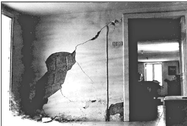
Lesioni da sisma – 23 novembre 1980 – A. Spizuoco
