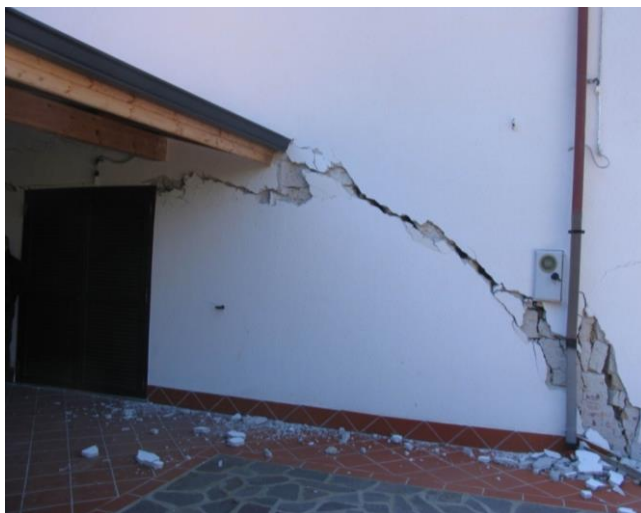
Cedimento “centrale” di parete muraria-A. Spizuoco 2009
