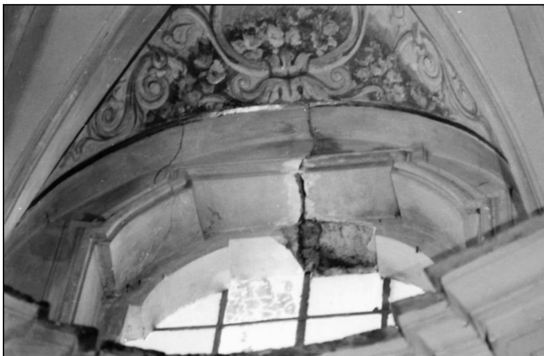
Lesioni in chiave di un'arcata della Chiesa Madre, Afragola (NA) – A. Spizuoco 1981
