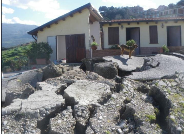
Fabbricati in area di frana a San Fratello (Me)-A. Spizuoco 2010
