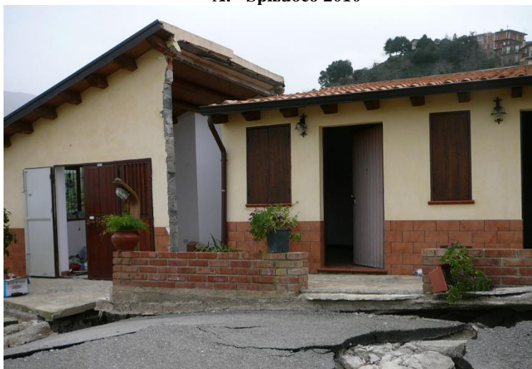
Fabbricato tranciato in due tronchi nell'area di frana – San Fratello (ME) - A. Spizuoco 2010
