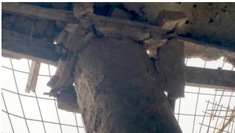
Schiacciamento del “pulvino” in testa al pilastro residuo e deformazione del “colletto” in ferro in testa al pilastro, nonché deformazione della coppia di travi in ferro su cui scaricava il solaio crollato. Si nota anche la traccia sul pilastro di una parete “demolita” prima del crollo - A. Spizuoco 2015
