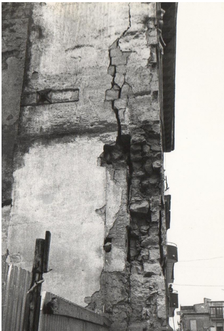
Particolare del dissesto alla torre civica dell'orologio A. Spizuoco 1980
