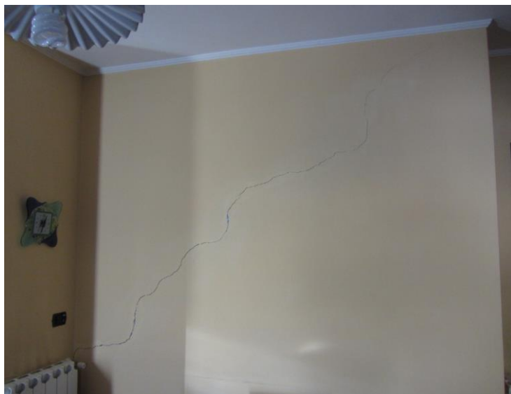
Lesione causata dalla deformazione del solaio inferiore. A. Spizuoco 2013
