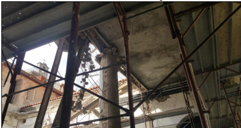
Deformazioni del “pulvino” in testa al pilastro e coppia di travi in ferro su cui scaricava il solaio crollato – si nota anche la traccia sul pilastro di una parete “demolita” prima del crollo – A. Spizuoco 2015
