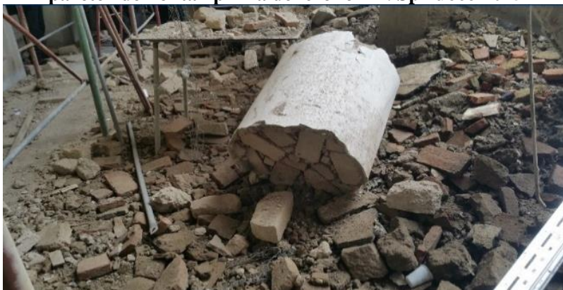
Residuo pilastro crollato in cui si nota la cattiva “fattura” della muratura – A. Spizuoco 2015
