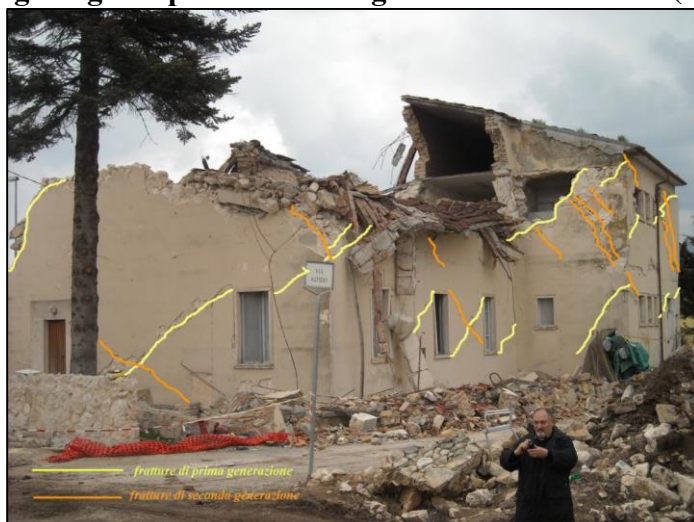
Fratture generate dalla prima onda sismica e da quelle successive Onna (AQ) Sisma aprile 2009 – A. Spizuoco
