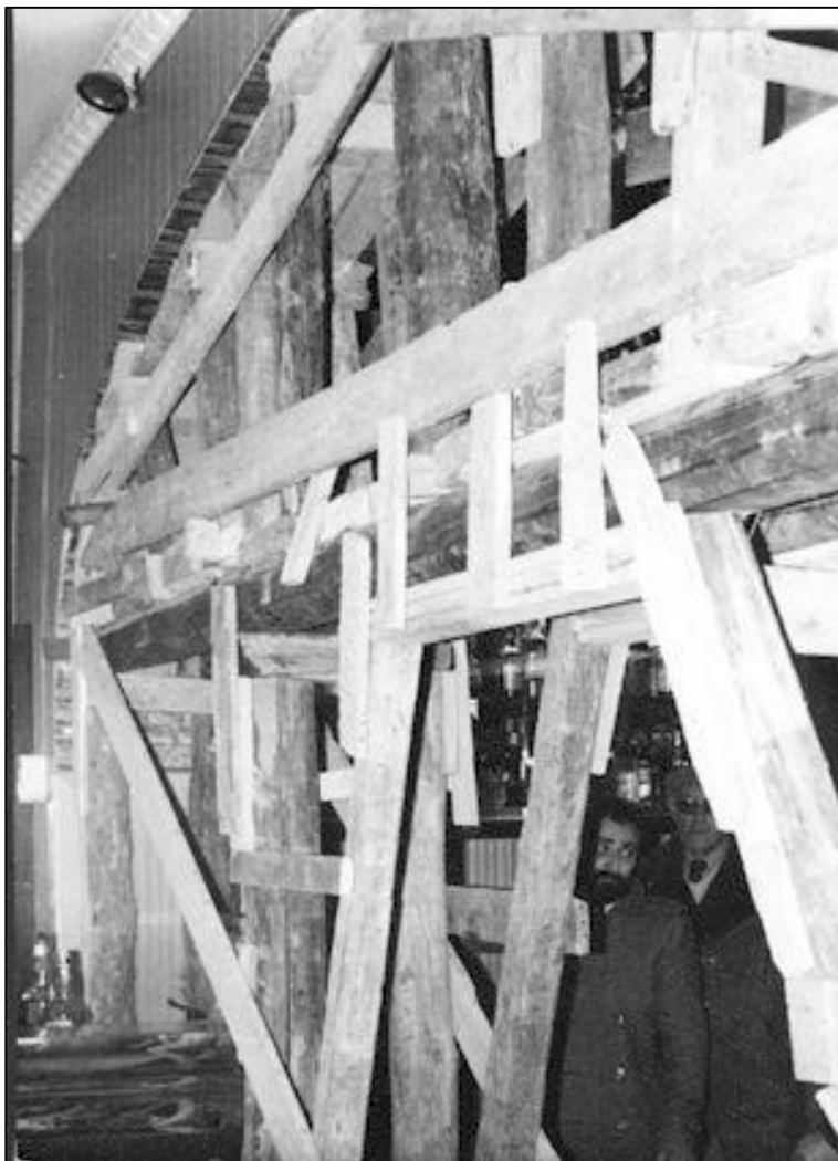
Puntellatura dell'arco di cui innanzi predisposta negli anni 80 dall'ing. Angelo Spizuoco.
