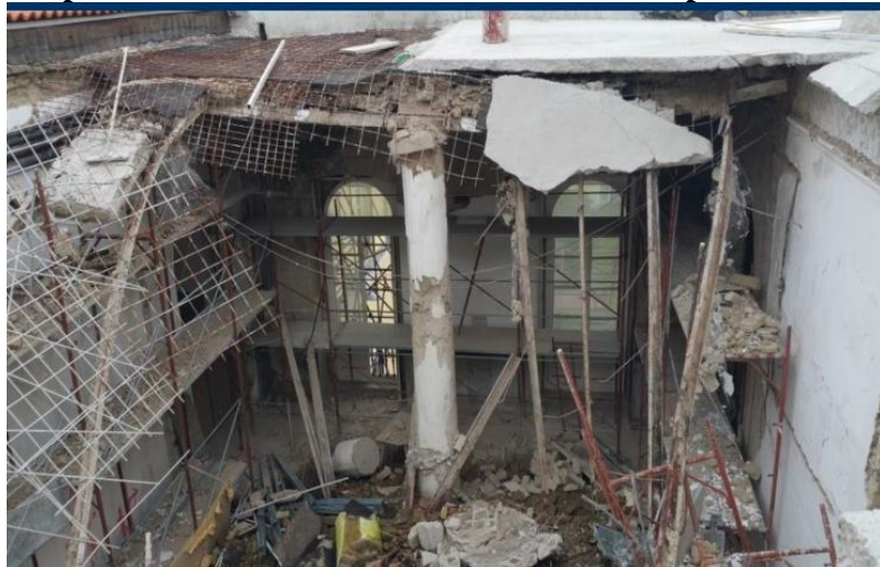
Residuo della zona crollata ove si nota lo schiacciamento localizzato in testa al pilastro “superstite” e la deformazione delle travi IPE sovrastanti. Va notato che la
