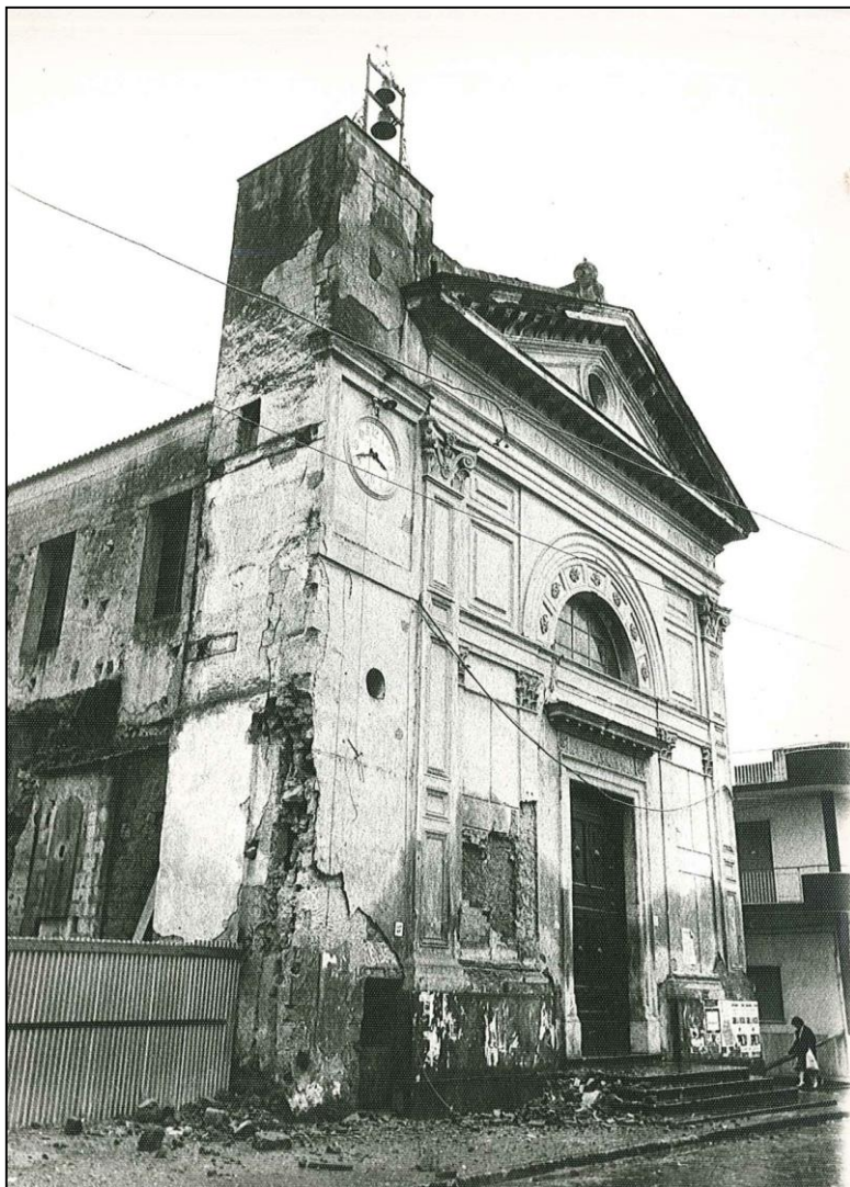
Dissesto da sisma 23-11-1980 Chiesa di San Vitaliano (NA)
