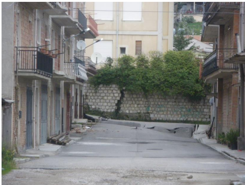
Cedimento di roto-traslazione - A. Spizuoco 2010
