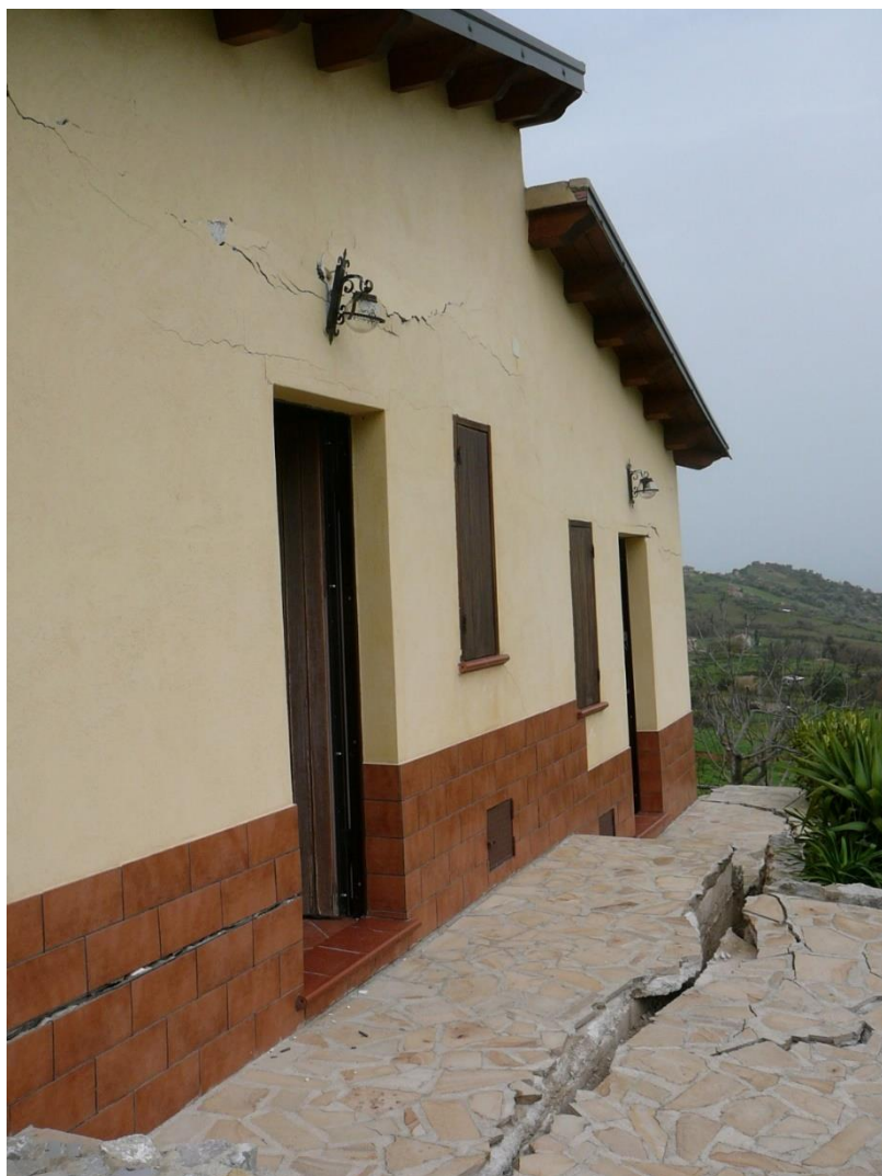
San Fratello (ME): Fratture sulla parete di un fabbricato e a terra per effetto del fenomeno franoso – A. Spizuoco 2010
