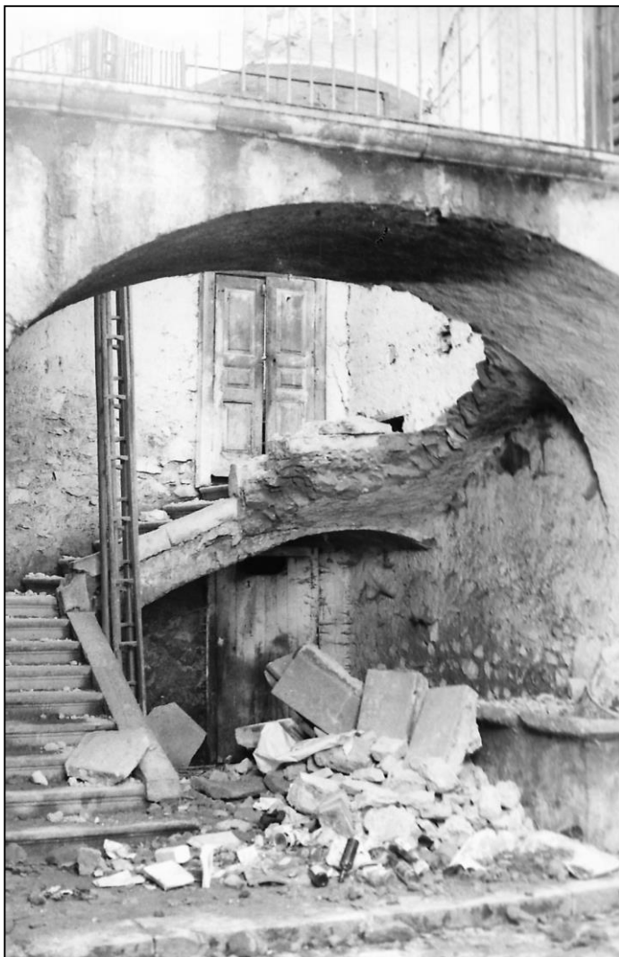
Crollo delle volte a mezza botte rampante della scala, Sisma del 14 febbraio 1981 - Visciano (NA) – A. Spizuoco
