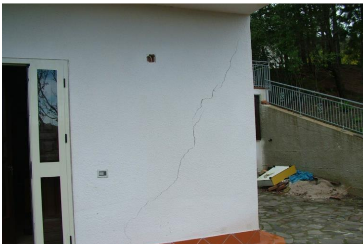
Cedimento di “estremità” in una parete muraria. A. Spizuoco 2009
