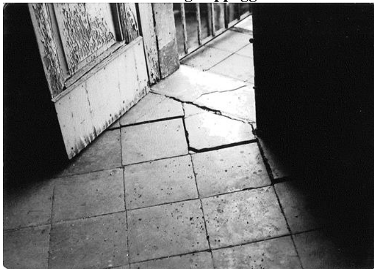
Dissesto estradosso solaio per tentativo di sfilamento travi sottostanti in corrispondenza di una porta - A. Spizuoco 1981
