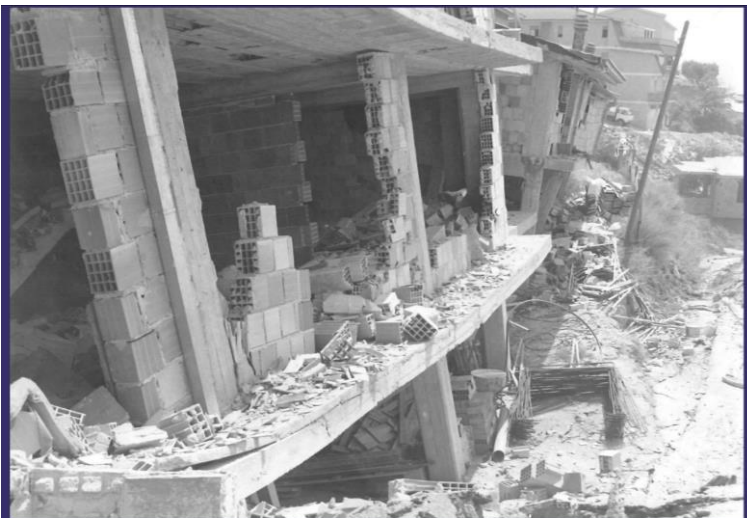
Zona al piede di frana (27/7/1986): da notare la diversa inclinazione dei due corpi di fabbrica edificio n°8
