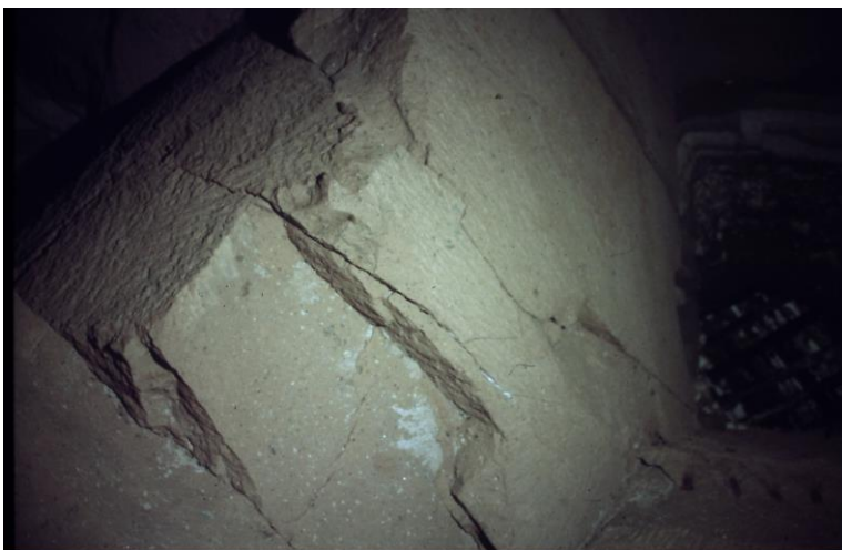
Zona fratturata tra i pozzi n°33 e 34 con evidente espulsione di blocco tufaceo
