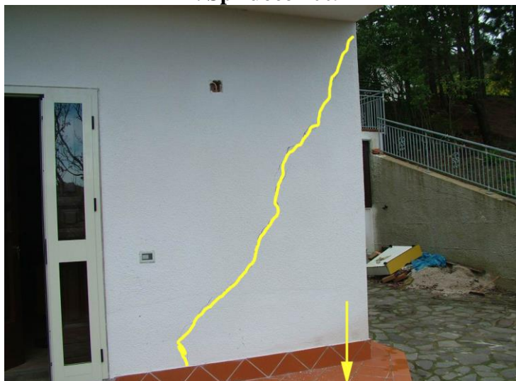
Direzione del cedimento interessante la parete. A. Spizuoco 2009
